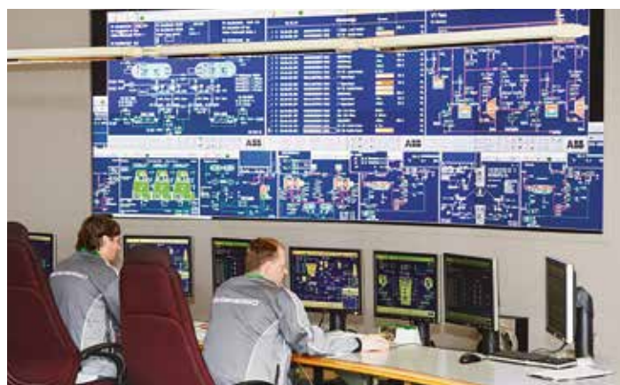
Teplárna ŠKO-ENERGO je vybavena špičkovými technologiemi.
