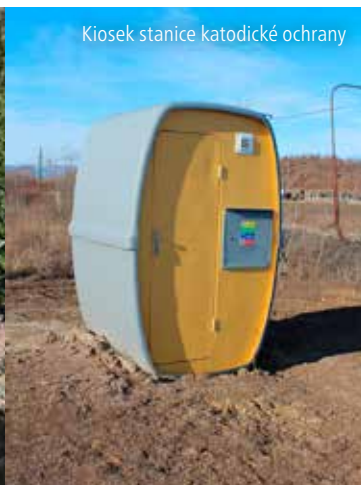
Instalace katodické ochrany
